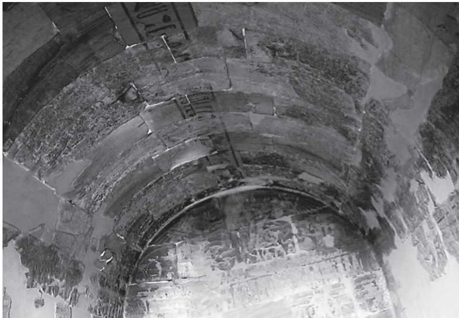
Fig. 10: Interior de la bóveda adovelada del Templo de la Divinas Adoratrices de Medinet Habou en Luxor (M. Durán)
