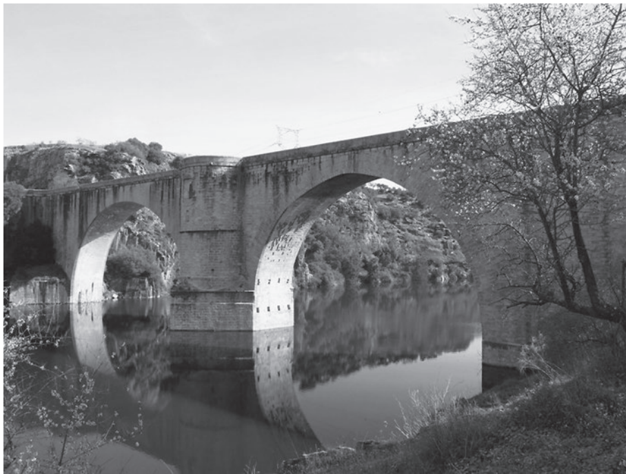
Fig. 22. Vista del lado aguas abajo del Puente de Almaraz (Cáceres) (M. Durán)
