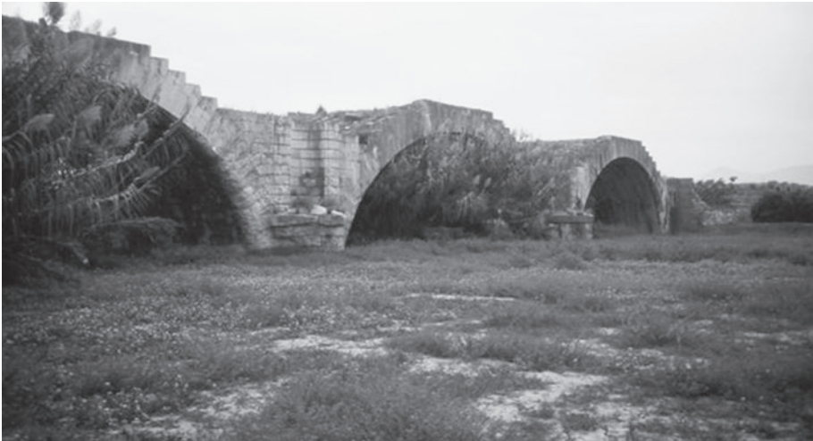
Fig. 23: Vista del puente sin rematar en las cercanías del río Júcar en el trazado inicial del Camino Real de Madrid a Valencia (M. Durán)
